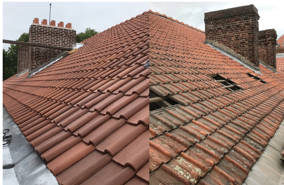
À gauche : couverture de tuiles pannes picardes sur le pavillon central après restauration. À droite : couverture de tuiles mécaniques sur le pavillon central avant restauration.
