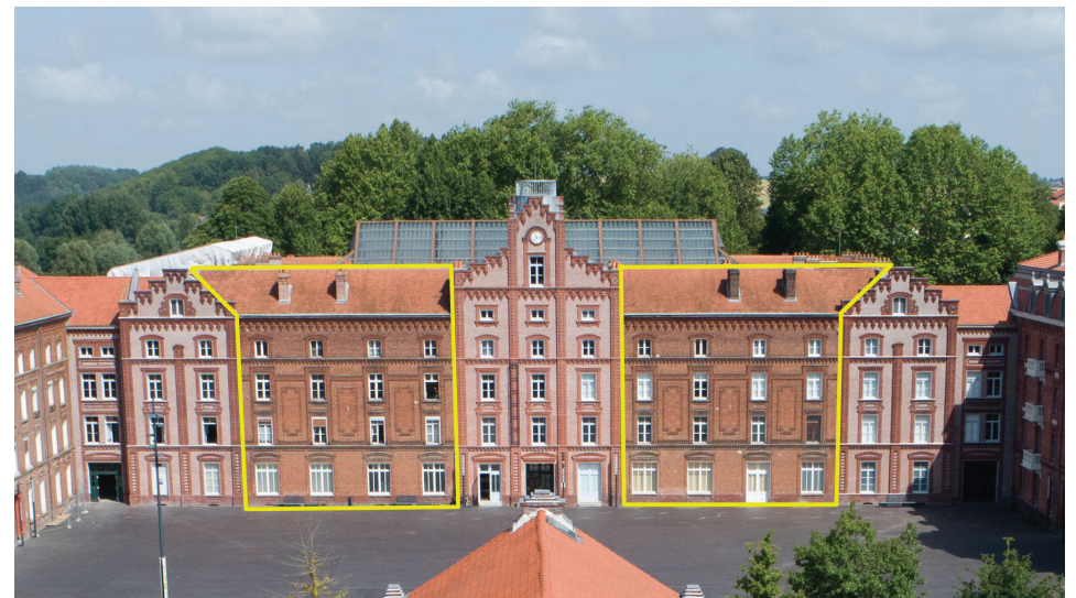
Façade sud du pavillon central du Palais social : parties de la façade restant à restaurer.
