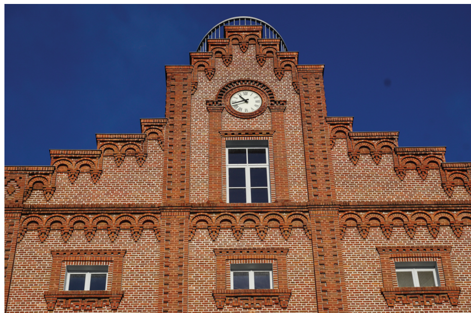
La brique orangée de l'avant-corps de la façade sud du pavillon central.
